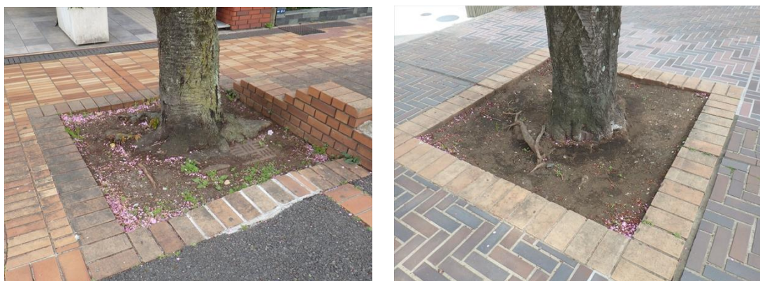
写真2 左右とも) 露出根が有り、踏板を取り込んでいる。
