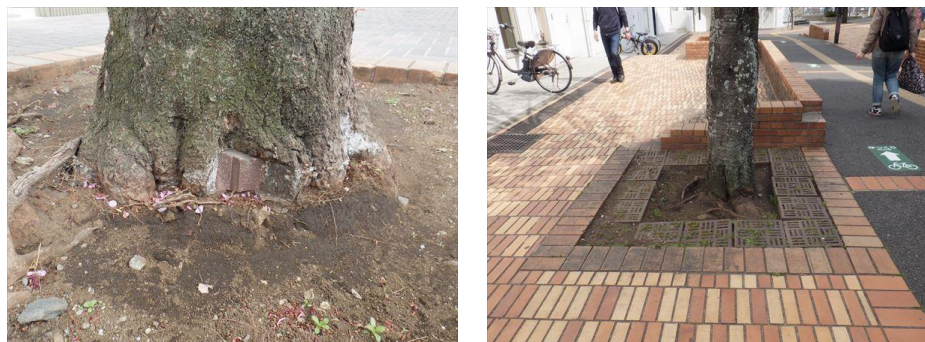
写真 11 左) 踏圧防止版の食い込み 右) 踏圧防止版の不陸
